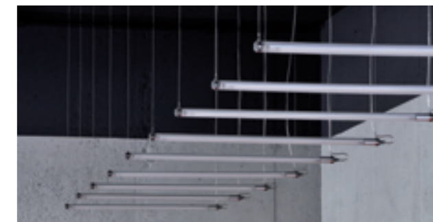
Die abgehängte Decke wurde entfernt und die vorhandene Rohdecke mit Akustikplatten verschraubt
